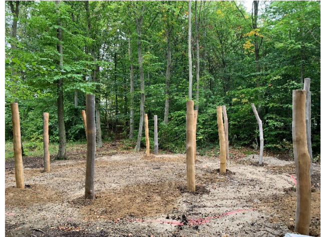
Stolperne til bålhytten er sat og i næste uge starter konstruktionsarbejdet for alvor.
